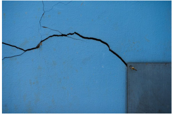
Grietas falsas en los muros
